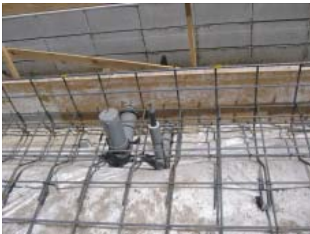
キッチン用 給水管 排水管
