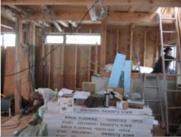
左/分電盤付近 右/1階配管配線
