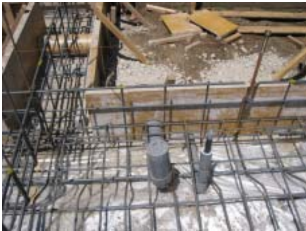
WC1 給水管 排水管
