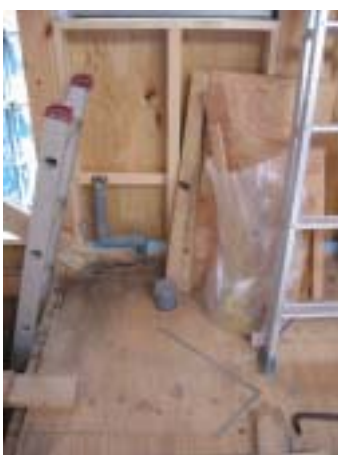
2階配管 WC2の配管
